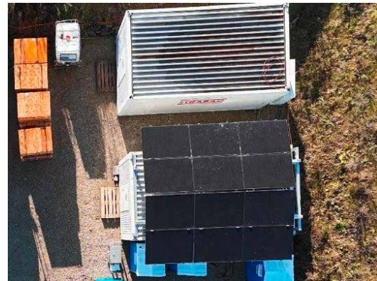
Abb. 1: Vogelperspektive der Containerdach-PV
